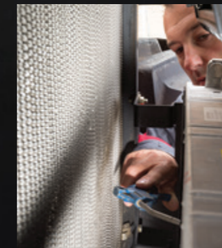
Ruime toegang tot de radiateurs om deze te reinigen.
